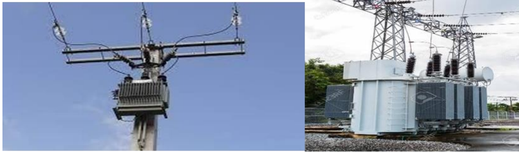
Figure I.4 : Les postes de transformation.
