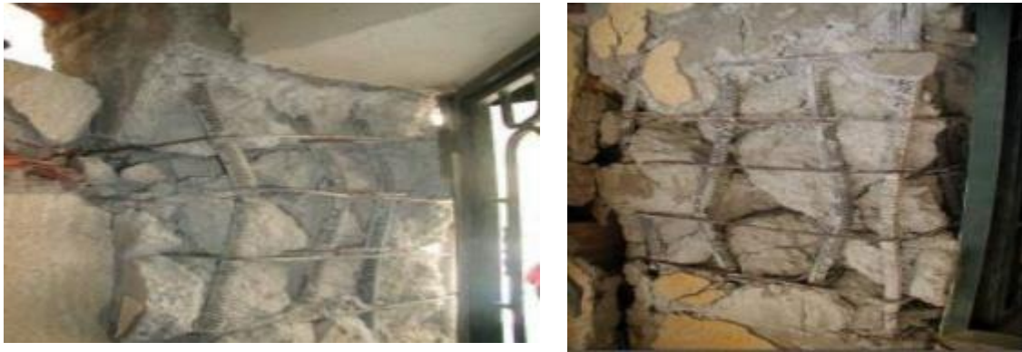
Figure 1.9: Ecrasement de béton et flambement des aciers dans les deux poteaux de la cage d'escaliers.
