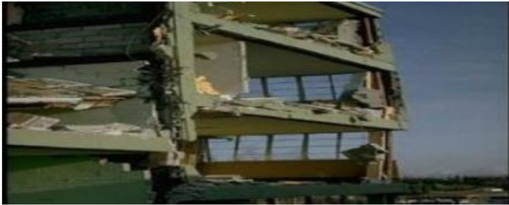
Figure 1.12: Dislocation des remplissages de maçonnerie
