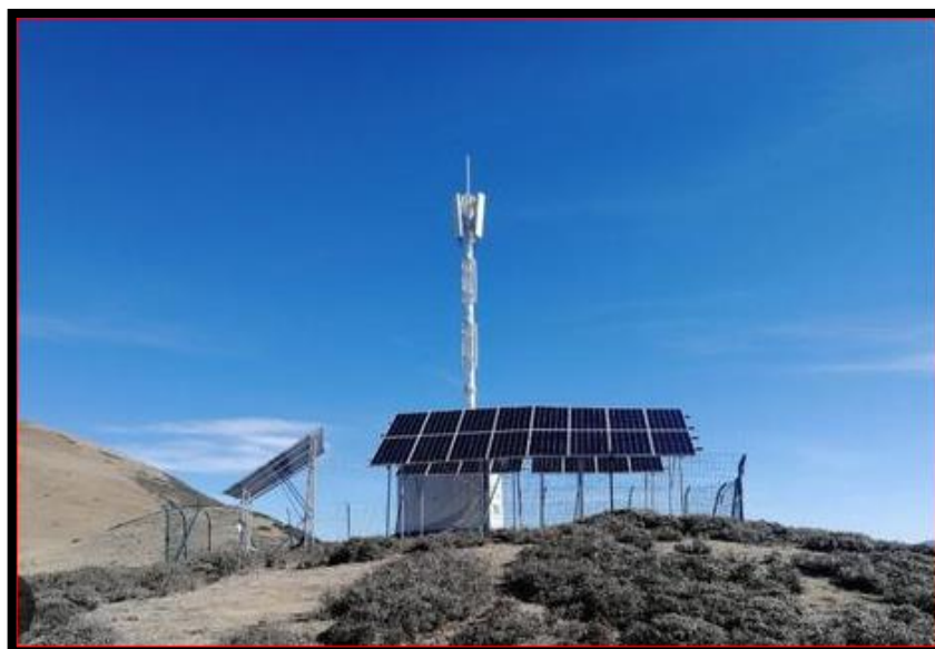
Figure I.7 : Exemple sur l'application de système PV autonome en stations de télécommunications.
