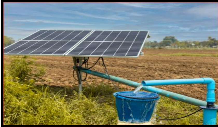
Figure I.6: Exemple sur l'application de système PV autonome en pompage d'eau
