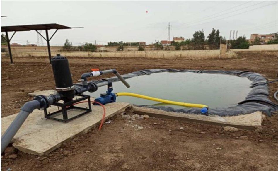
Figure 23 : Bassin d'irrigation avec une pompe.
