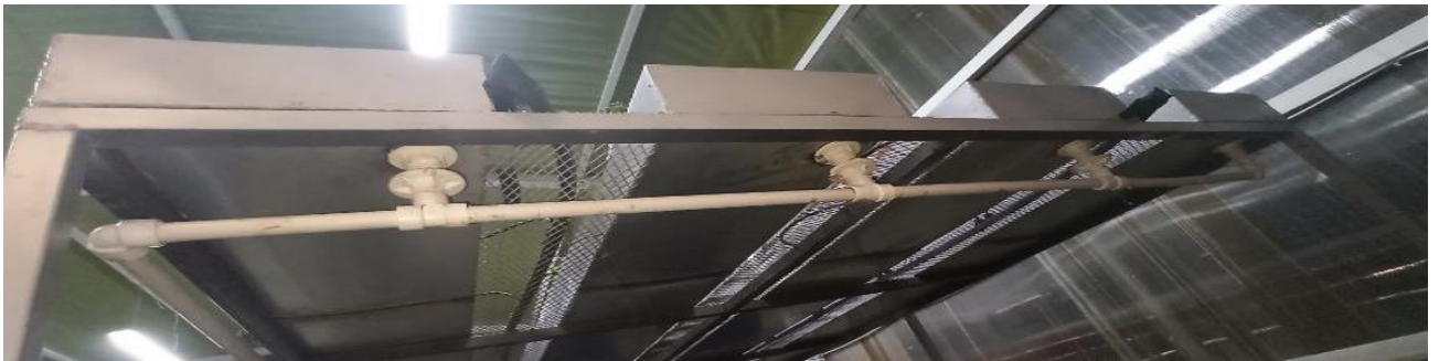
Figure 22 : instalation drainage système table goutte a goutte avec substrat
