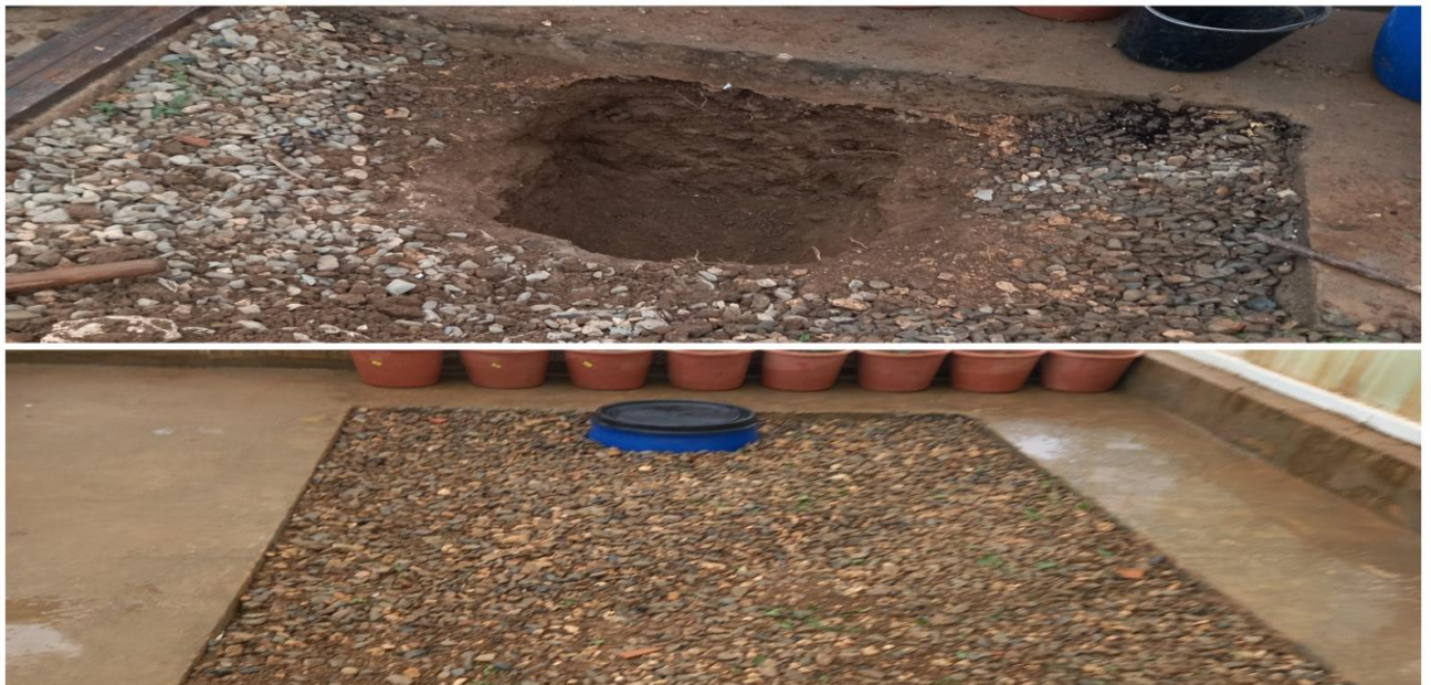
Photo 4 : installation de reservoir de système NFT escalier Source : (Abdellah Mhdjoubi,B.&.Boudejma Djefal,Y.2022)
