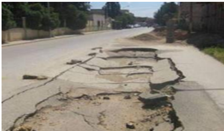
Figure 1.8 - Affaissement d'une chaussée routière- Tizi Ouzou (2016)
