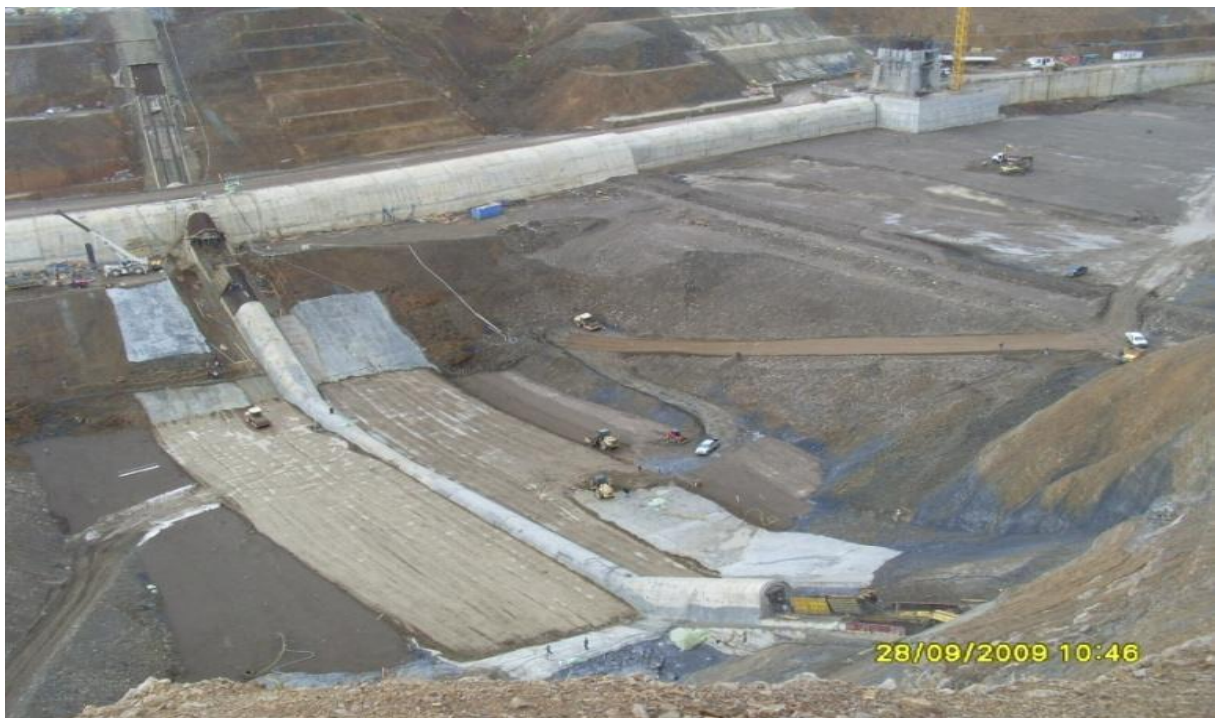
Figure 1.10 - Stabilisation par compactage de surface (cas d'une digue de barrage en terre de Kef-Eddir construit à Tipaza en 2009, Algérie) (hamid, 2017).
