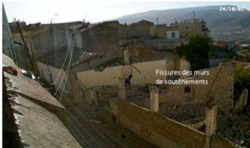
Figure 1- 2 : Conséquence des glissements de terrains de Constantine (Tir., 2003).
