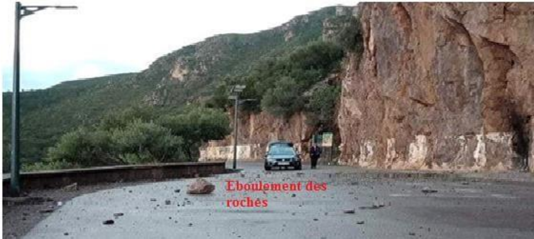
Figure 1- 11: Eboulement rocheux s’est produit, le Mardi 23 Mars 2021, sur le site de Cap Carbone, non loin de la faille du séisme qui a ébranlé Béjaïa jeudi 18 Mars 2021, sans faire de victimes.
