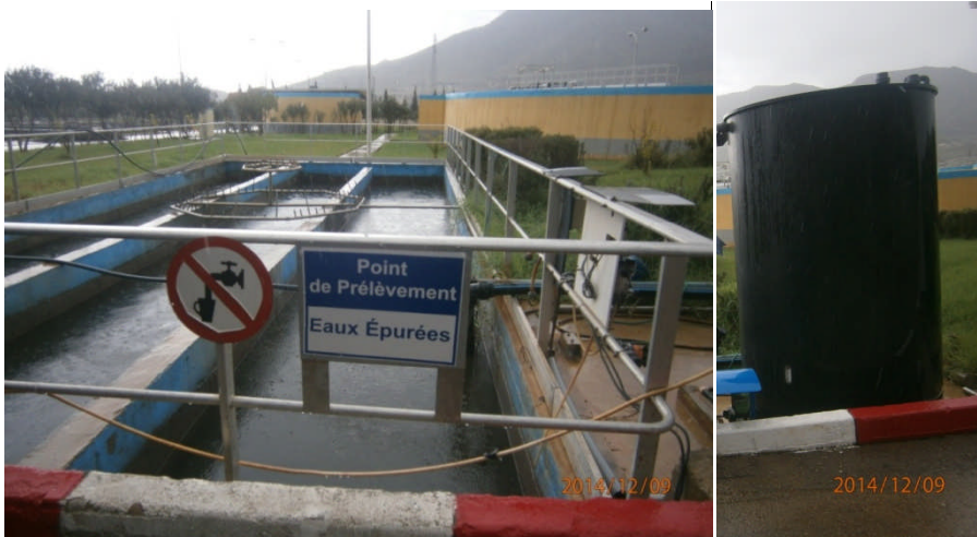
Photo 06 : bassin de désinfection dans la STEP de Ain Defla. (Source Touhari)
