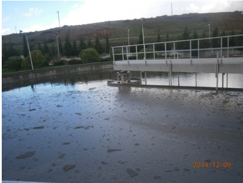
Photo 02: Bassin de décantation dans la STEP de Ain Dfela. (Source Touhari)
