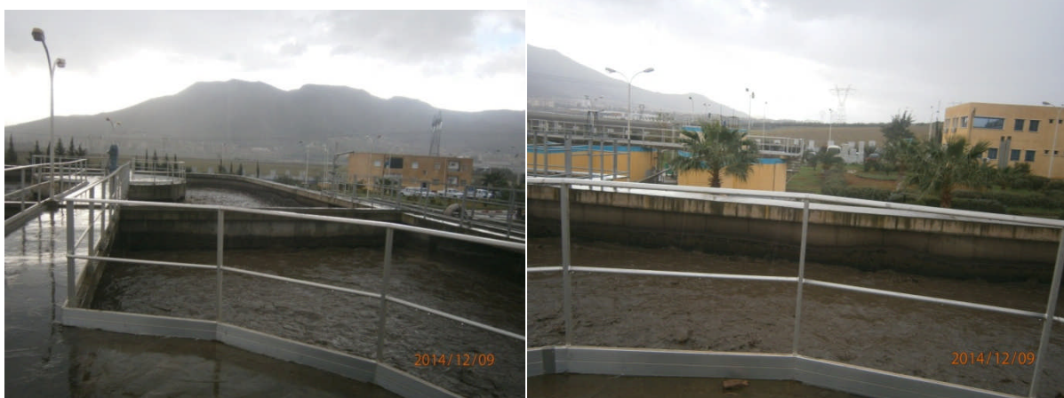
Photo 04: bassin d'aération a boue activée dans la STEP de Ain Defla. (Source Touhari)
