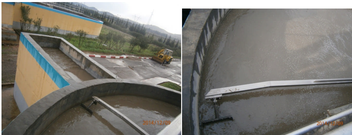
Photo 01: Dégraissage - Déshuilage dans la STEP de Ain Dfela. (Source Touhari)
