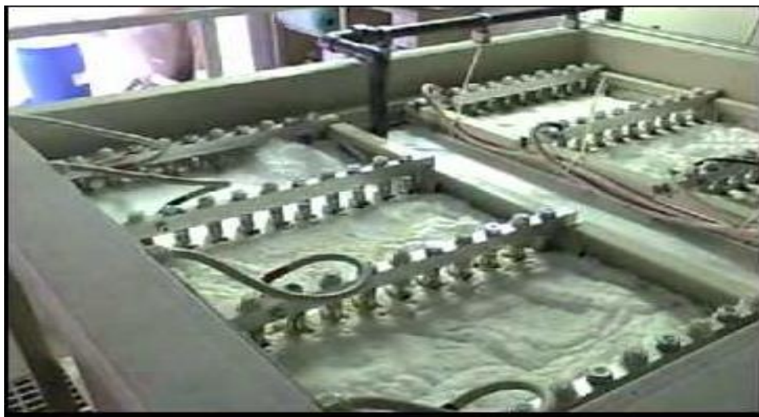
Figure II-6 : Unité de traitement par l'électrocoagulation
