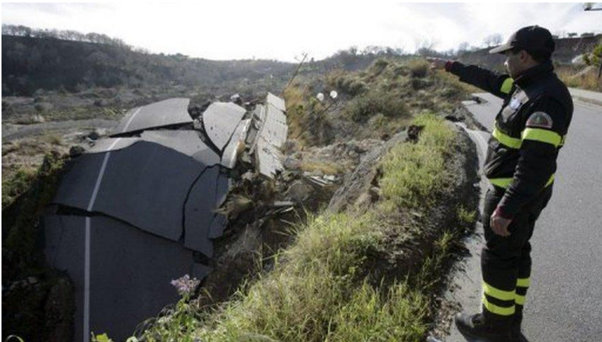
Figure 11: Maiereto landslide Italy, Calabria, 2010, (Italie: des milliers d'habitants évacués après un spectaculaire glissement de terrain, 2010).
