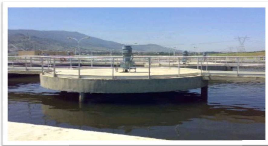
Photo 4 : Bassin d'aération. Source : STEP de Ain Defla.
