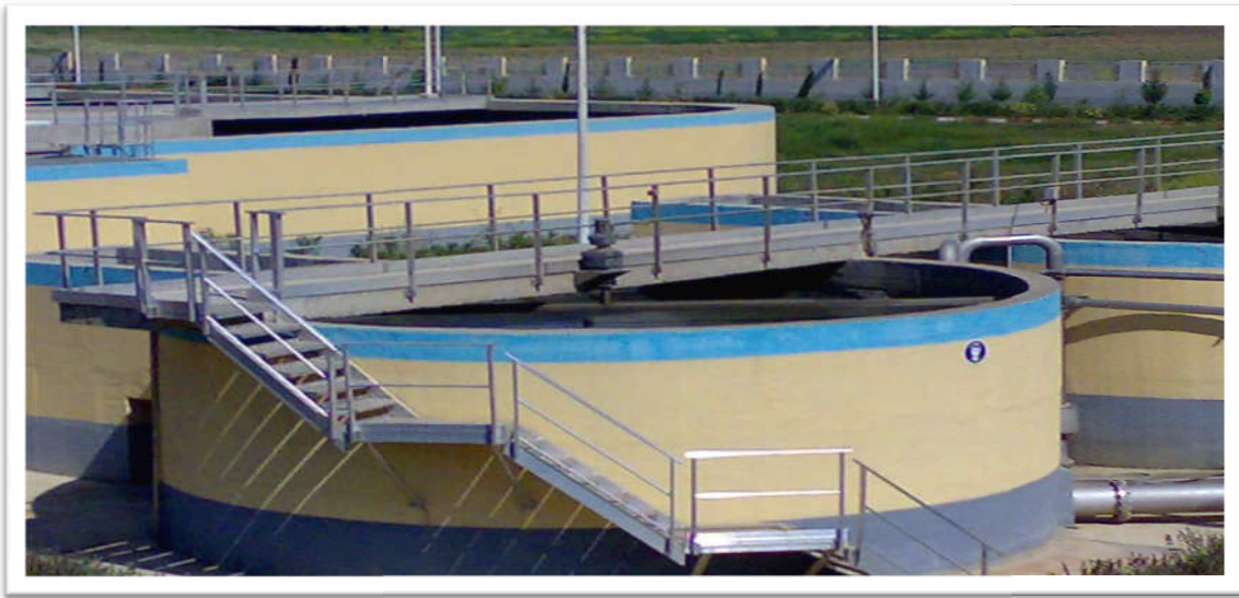
Photo 2 : Dessableur et déshuileur. Source : STEP de Ain Defla
