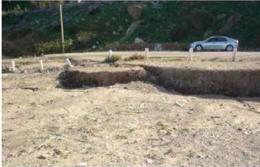
Figure I-14: Glissement en bas du talus (Les Abattoirs Ténès)
