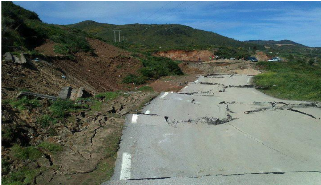
Figure I-5: Affaissement sur la route nationale n° 24 reliant Bejaia à Tizi-Ouzou (Bouteraa et Bendaas, 2019).
