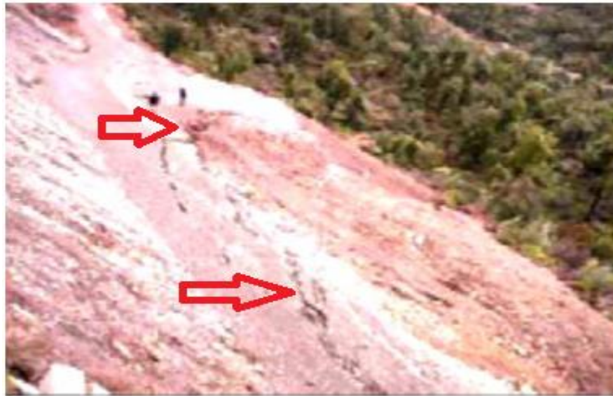
Figure I-13 : Fissures longitudinales dans la route affectée par le glissement.
