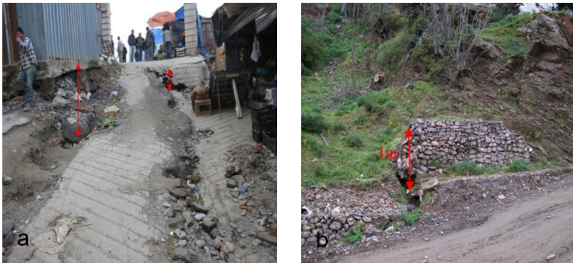
Figure. I-16: Les déformations dans la ville d'Ain El Hammam (Bouaziz et Melbouci, 2014).
