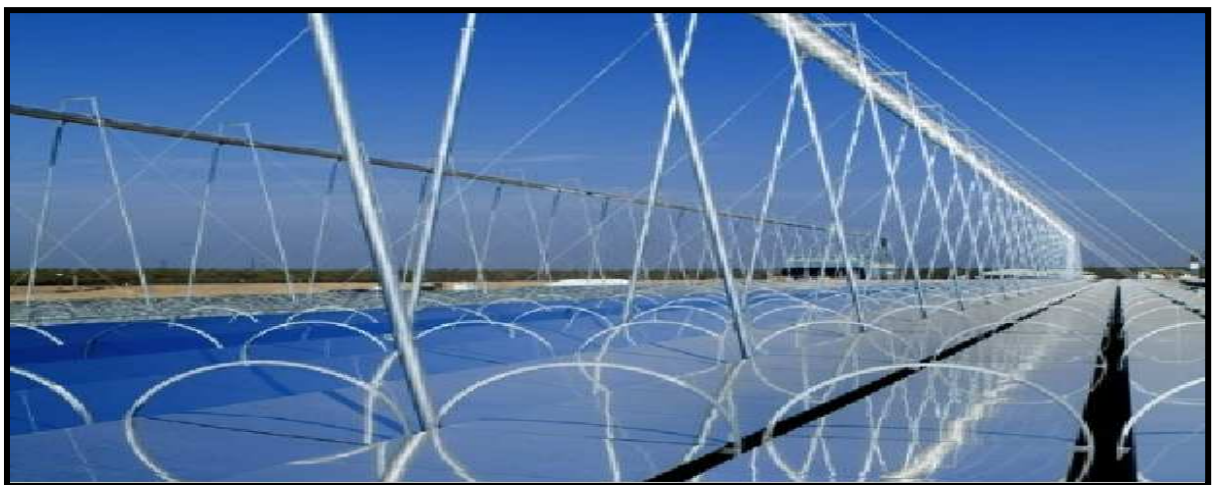
Fig. I. 2: Concentrateur solaire Filière Fresnel
