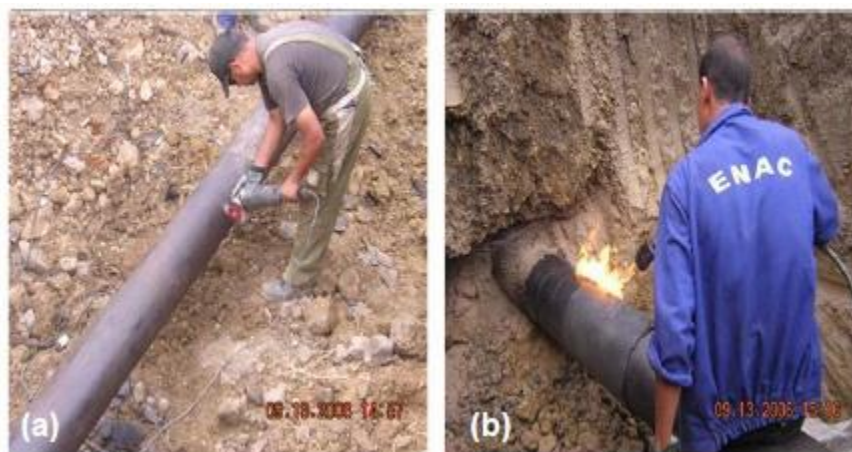
Figure III.8: (a) réparation de surface pour réfection enrobage, fuite de Bentalha (Oran, Algérie), réfection enrobage
