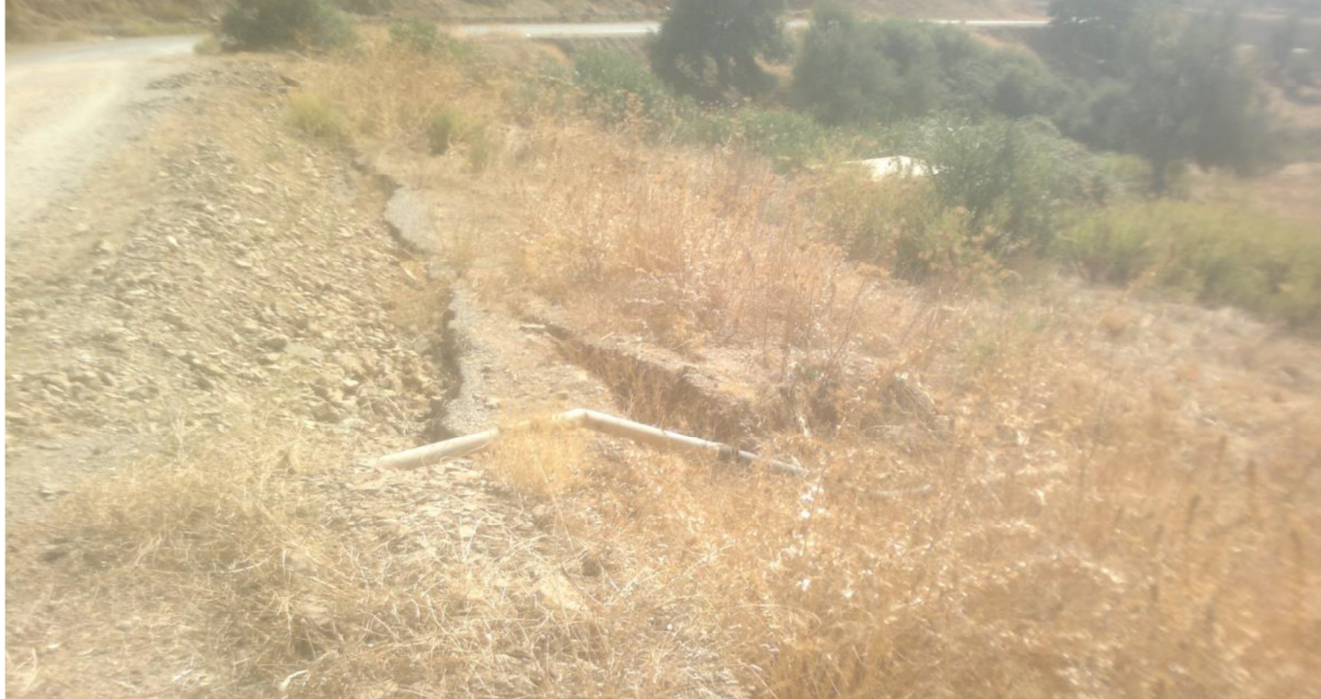
Figure 20. Fissures longitudinales sur la bordure gauche de la route (Photo DTP, inédit, 2017)
