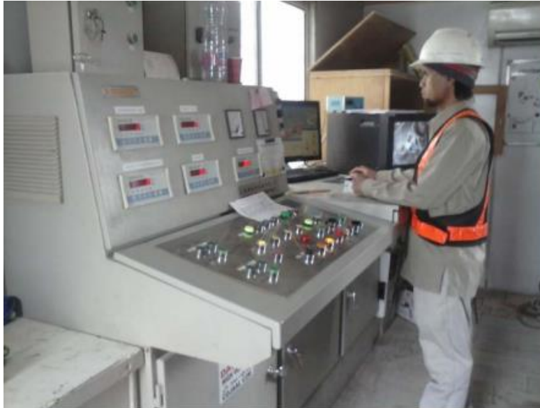
Figure I.13 Poste de commande de la centrale à béton [4].
