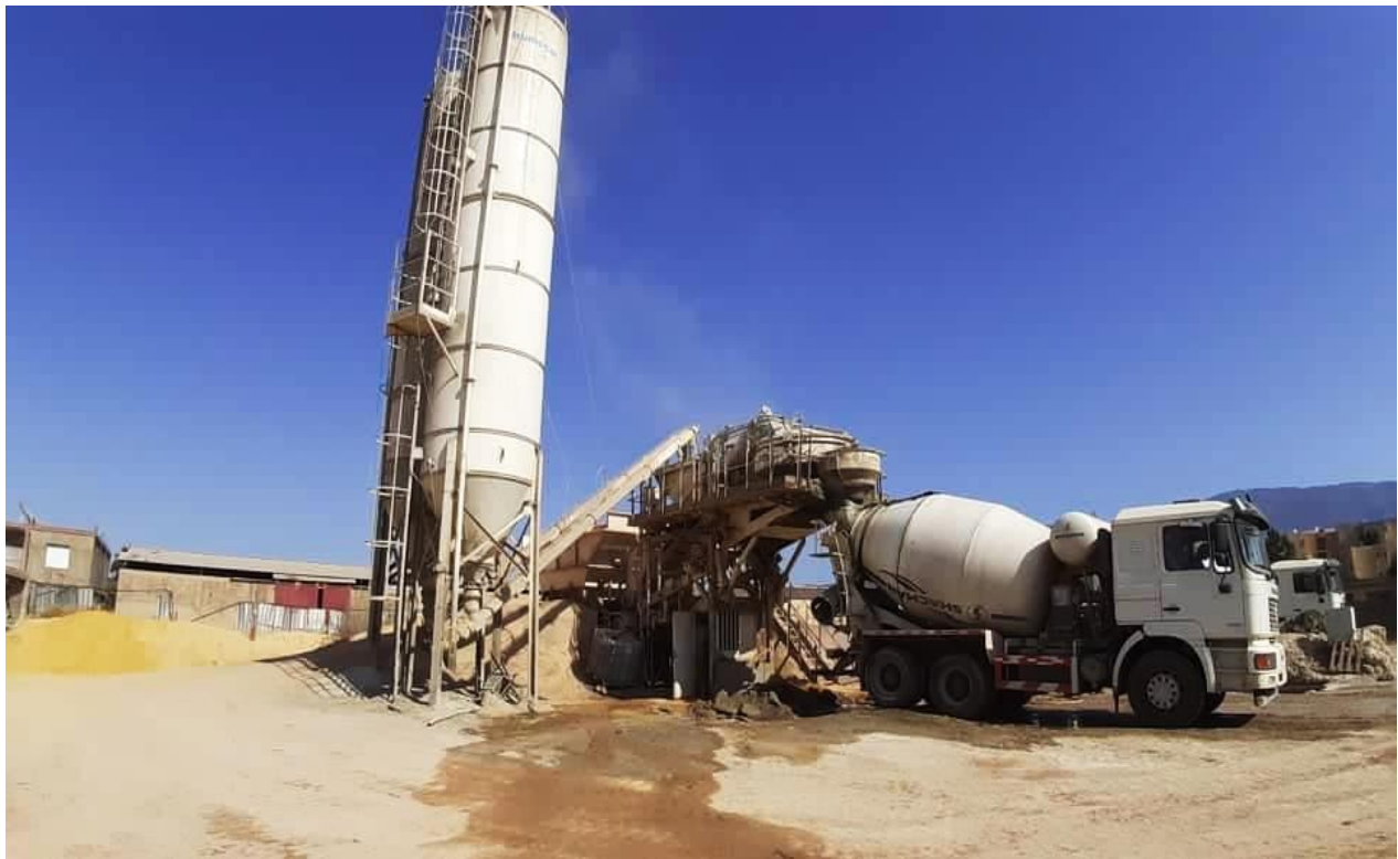
Figure I.5 Une photo réelle d'une centrale à béton de type mobile et automatique à KHEMIS MILIANA, AIN DEFLA, ALGERIE.
