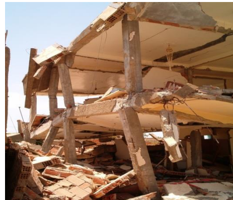
(d) : Dislocation de la structure -éclatement de tous les nœuds-
