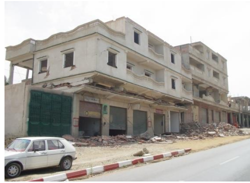
(b) : Écroulement d'un étage souple intermédiaire.
