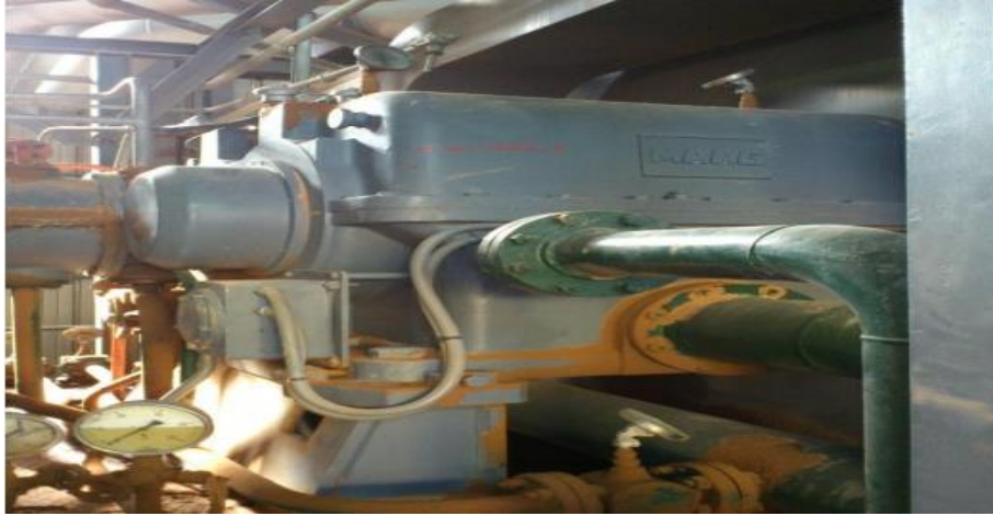
Figure II-29: photo réelle montrant un multiplicateur (Gear Box)
