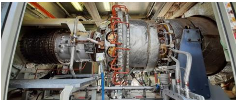
Figure II-1: Turbine à gaz modèle GE MS-5002
