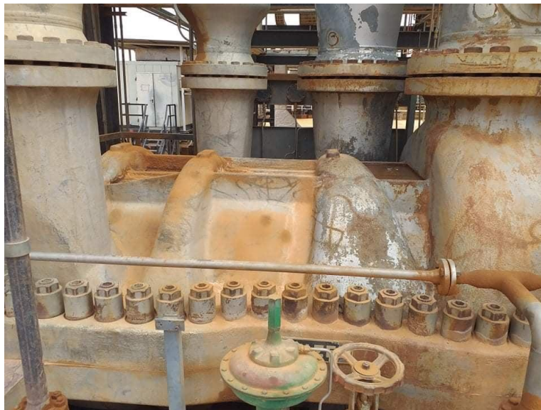
Figure II-32: Photo réelle du compresseur centrifuge de la base DP-STAH
