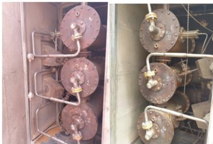
Figure II-16 : Vue de coté sur les chambres de combustion
