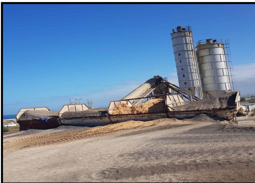
Figure I-25 : Centrale à béton.
