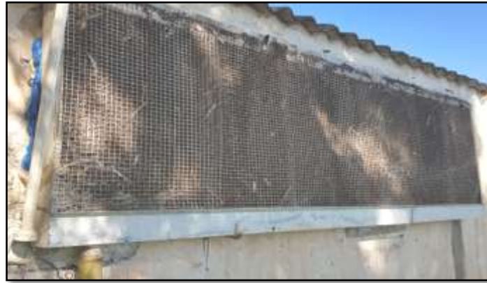
Photo N°8 : Système d'humidification (pad-cooling) (Photo personnelle).
