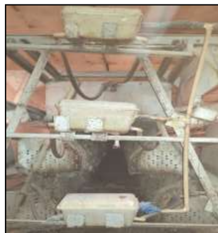
Photo N°18: Bacs d'eau des batteries (Photo personnelle).
