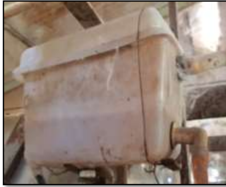
Photo N°22 : Présence de toile d'araignée (photo personnelle).
