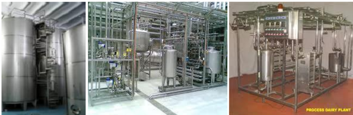
Figure 05: Equipement laitiers. (A) : tanks de stockage du lait, (B) : système de canalisation (lactoducs), (C) : un échangeur thermique à plaque ( Malek ,2013 ).
