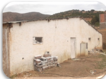
Photo 22 : Absence de pédiluve à l'entrée du bâtiment.
