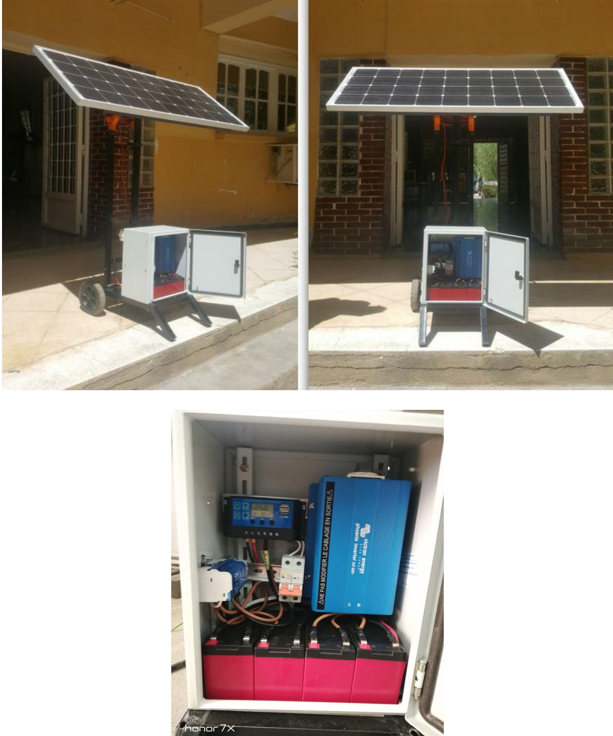
Figure III- 2 : L'installation finale du banc d'essai photovoltaïque.
