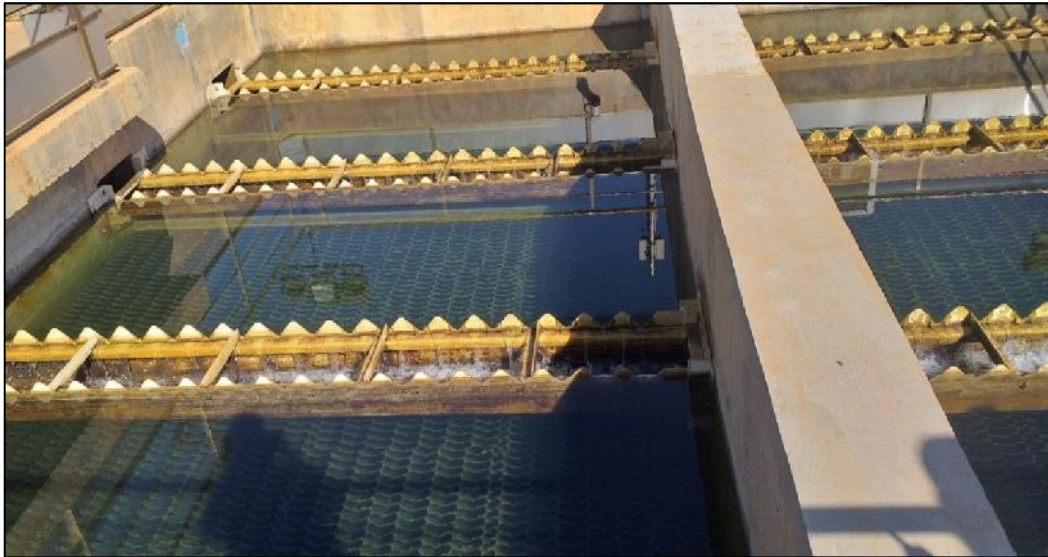
Photo 06: Bassin de décantation (29/04/2019).
