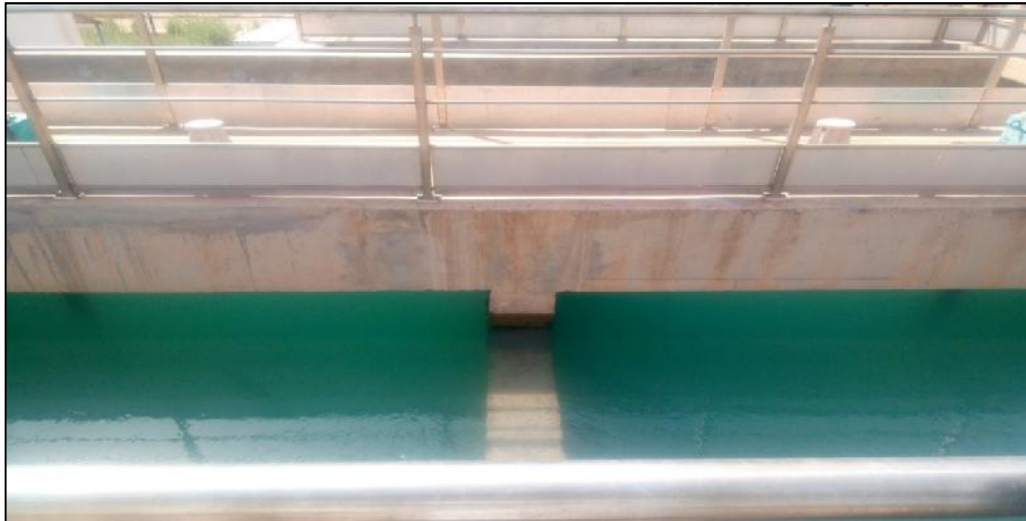
Photo 3: Bassin de floculation (29/04/2019)
