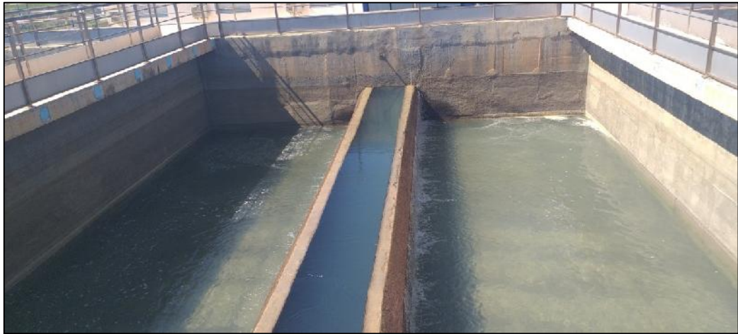
Photo 4: Filtres à sable (29/04/2019).
