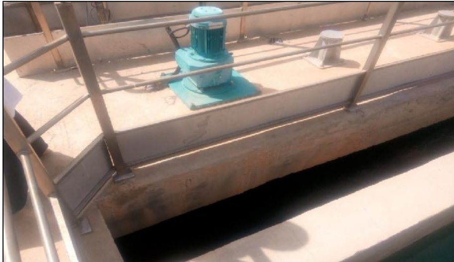
Photo 2: Bassin de coagulation (29/04/2019).
