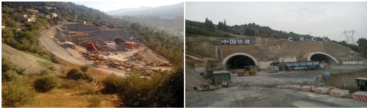
Fig. les deux tubes du tunnel de Sidi aich (au niveau de la tête nord)
