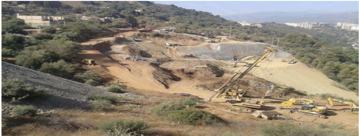
Fig. Début des travaux au niveau de La tête nord du tunnel de Sidi-Aich.
