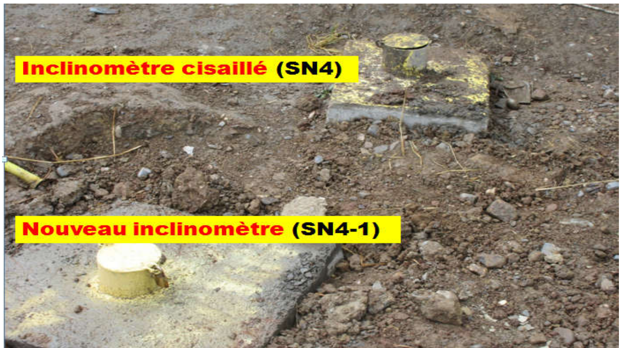
Fig. inclinometres installés au de niveau du tunnel
