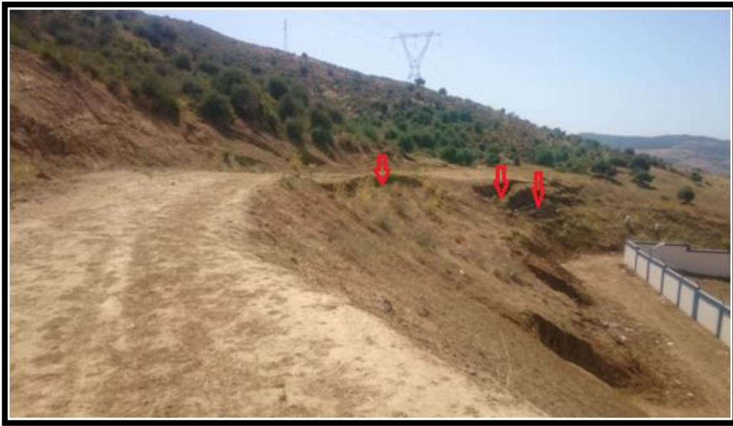
Figure 6. signe de glissement à la zone d'étude
