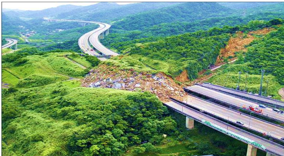
Figure 10 : Éboulement ou écoulement [13].
