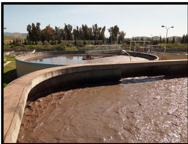
Photo 06: Bassin de clarification (17/04/2018)
