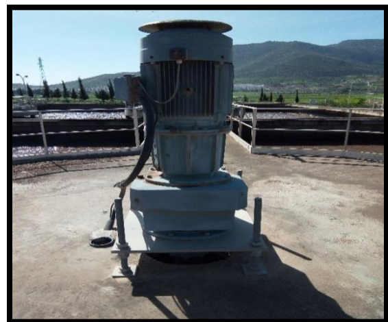
Photo 05: Aérateur de surface (17/04/2018)
