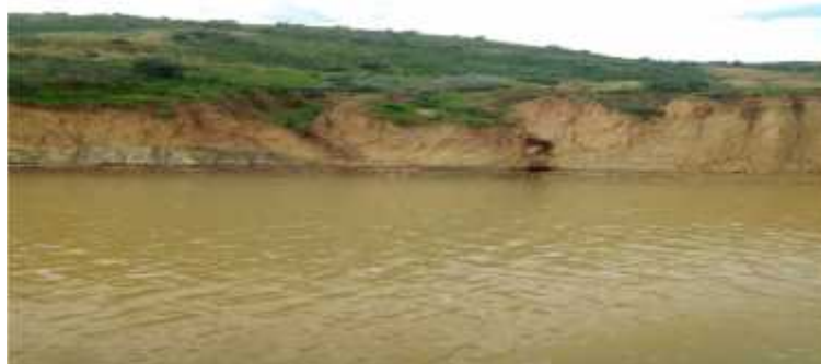
Figure n°02 : Erosion linéaire (barrage de Cheliff (MAO : Mostaganem Arzew Oran LOT n°1)) cliché par korieb et Guettar février 2018)
