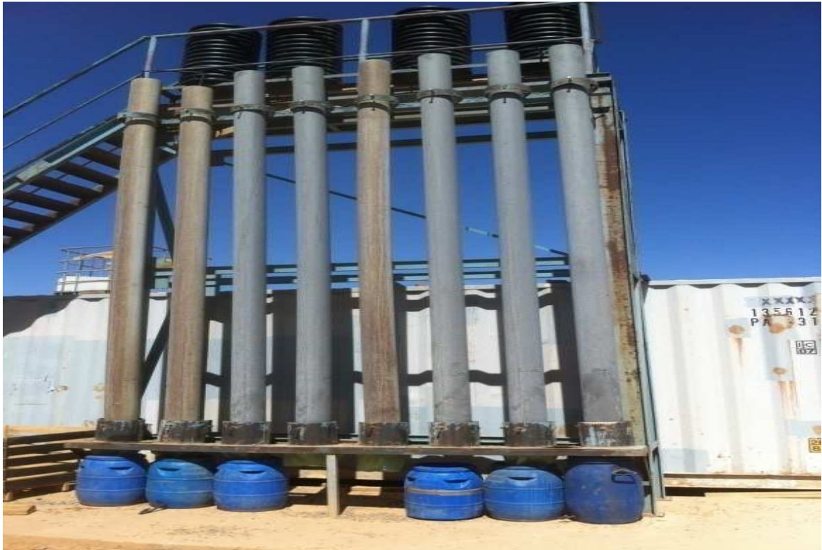
Figure. III.1 : Installation semi pilote de lixiviation en colonnes de lixiviation
