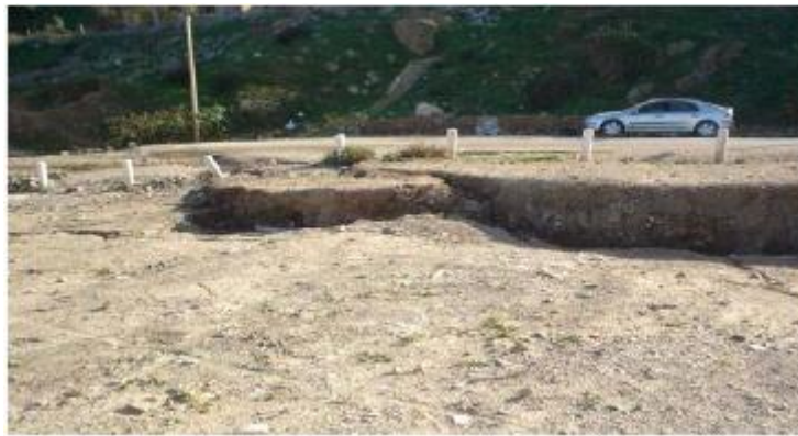
Photo 1.6 : Affaissement de plus de 50cm du glissement en bas du talus (Les Abattoirs Ténès)
