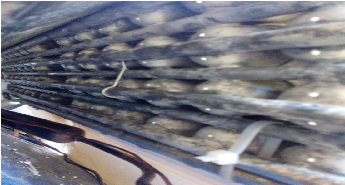
Figure 4.7 : serpentín de l'évaporateur
