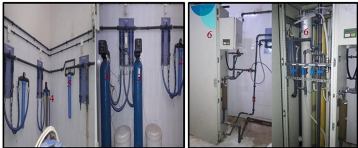
Figure 4. - Station de traitement des eaux du CH Miliana et Khemis-Miliana (1 : filtre à sable (50 \mu m) ,2 : filtre de 5 \mu m, 3 : adoucisseurs ,4 : filtre à charbon ,5 : filtre de 1 \mu m, 6 : osmoseur inverse)
