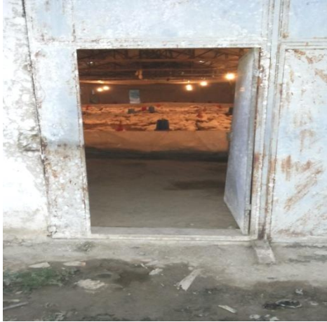
Photo 7: Absence de pédiluve
